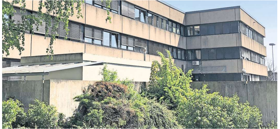
Das marode Peiner Polizeigebäude an der Schäferstraße.
